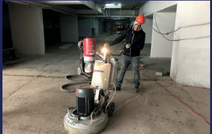
Pulido para rectificar hormigón mal afinado
